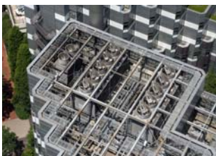
SBSの空調室外機
